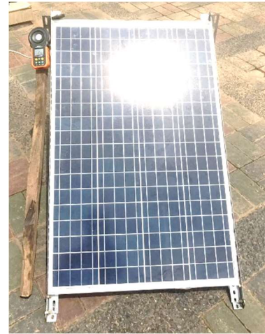
Gambar 4. Penempatan panel fotovoltaik (PV) di atas tanah ( ground mounting )
