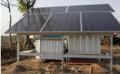
Gambar 1. Pembangkit Listrik Tenaga Surya.
