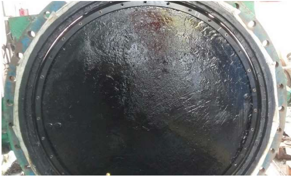
Gambar 9. Hasil perbaikan katup kupu-kupu
