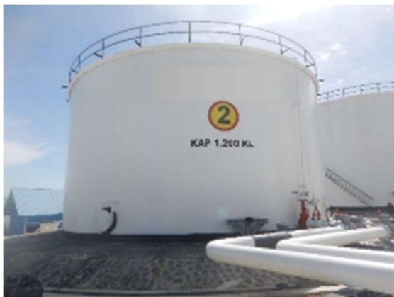
Gambar 1. Tangki Vertikal pada Instalasi Bahan Bakar
