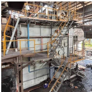
Gambar 1. Boiler Takuma N-600 SA
