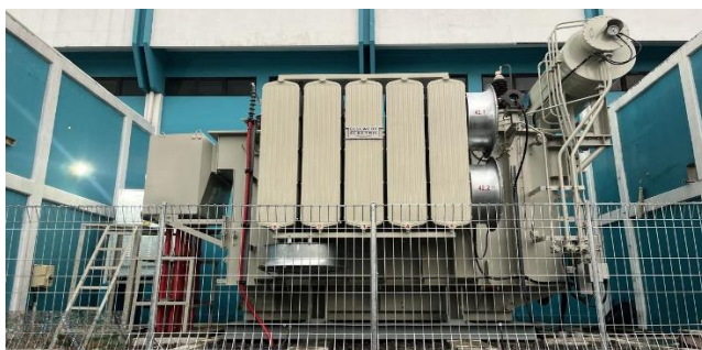
Gambar 1. Trafo 3 Gis Penggilingan.
