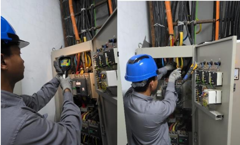
Gambar 3. Proses Evaluasi Kondisi Existing Panel Listrik
