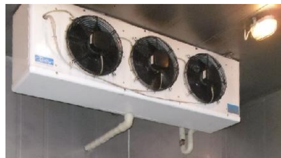
Gambar 1. Ruang Simpan Pendingin dan Evaporator
