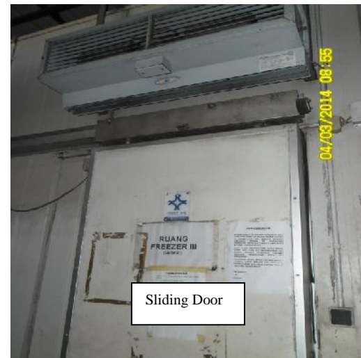
Gambar 8. Pintu Sliding di Gudang Pendingin
