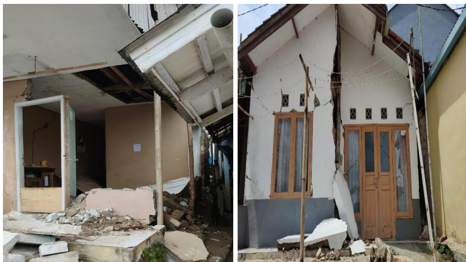
Gambar 1. Rumah warga yang rusak karena gempa (Sumber: Dokumentasi Tim PkM Cianjur KKM3)
